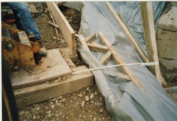
Abb. 3: Fehlerhafte Nutzung des erforderlichen Schutzstreifens
