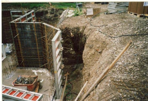
Abb. 5: Arbeitsplätze im Wirkungsbereich einer nicht gesicherten Böschungswand
