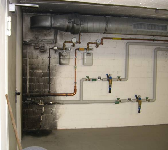
Bild 3: Aufnahme von der Ferngasübergabestelle im Keller des Gebäudes nach Reinigung des Kellerraumes
