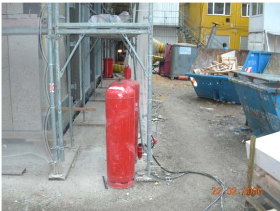
Abb. 2: Zwei nicht gegen Umfallen gesicherte Gasflaschen, eine davon ohne Schutzkappe. Beim Umfallen Gefahr des Abschlagens von Armaturen, dadurch Gasaustritt möglich. Explosionsgefahr!
