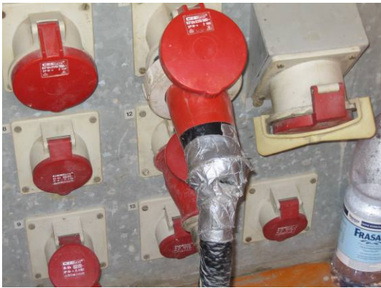
Abb. 1: Defekter 63 Ampere Stecker in Baustrom – Speisepunkt (Baustromverteilerkasten). Akute Lebensgefahr durch Stromschlag bei Berührung!
