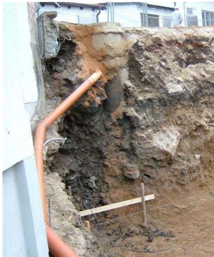
Abb. 7: Arbeitsplätze im Wirkungsbereich einer nicht gesicherten Böschungswand
