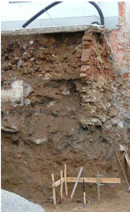
Abb. 8: Arbeitsplätze im Wirkungsbereich einer nicht gesicherten Böschungswand
