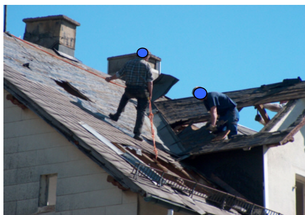
Bild 2: Abbrucharbeiten an einem Asbestzementdach: keine ausreichenden Sicherungsmaßnahmen gegen Absturz, unzulässiges Brechen der Dachplatten
