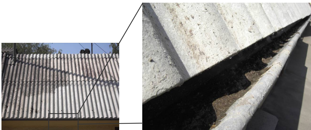
Bild 1: Eingestellte Tätigkeiten an einem Asbestzementdach, bei dem begonnen wurde, Bewuchs und andere Ablagerungen mit einem Hochdruckreiniger zu entfernen; im Detailausschnitt ist das Dach mit Dachrinne zu sehen, in der sich der durch das Reinigungsverfahren entstandene asbesthaltige Schlamm ansammelt
