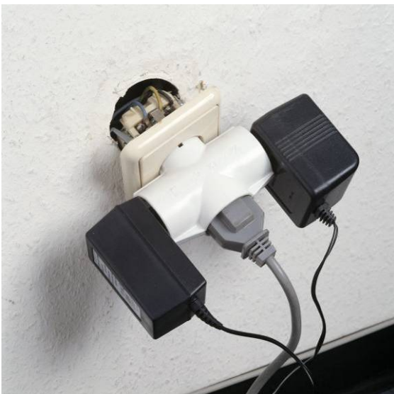
Bild 1: Gefahr der mechanischen Überlastung bei Verwendung eines nicht zulässigen Adapters
