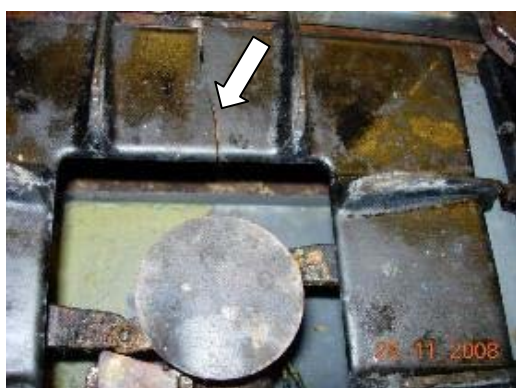
Abb. 4: Gebrochene Herdeinsätze: Verbrühungsgefahr durch mangelnde Standsicherheit des Kochtopfes
