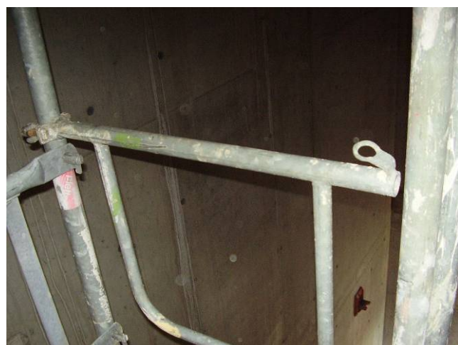
Bild 5: Seitenschutzteil an Schmalseite unzulässig eingebaut und drehbar
