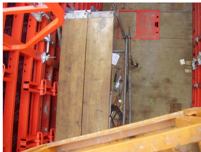
Bild 4: keine Abstiegsleiter auf Gerüstbelag, ca. 2,9 m tiefer und ohne Seitenschutz
