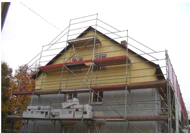
Bild 6: Giebelseite mit vorschriftsmäßigem Dachfanggerüst
