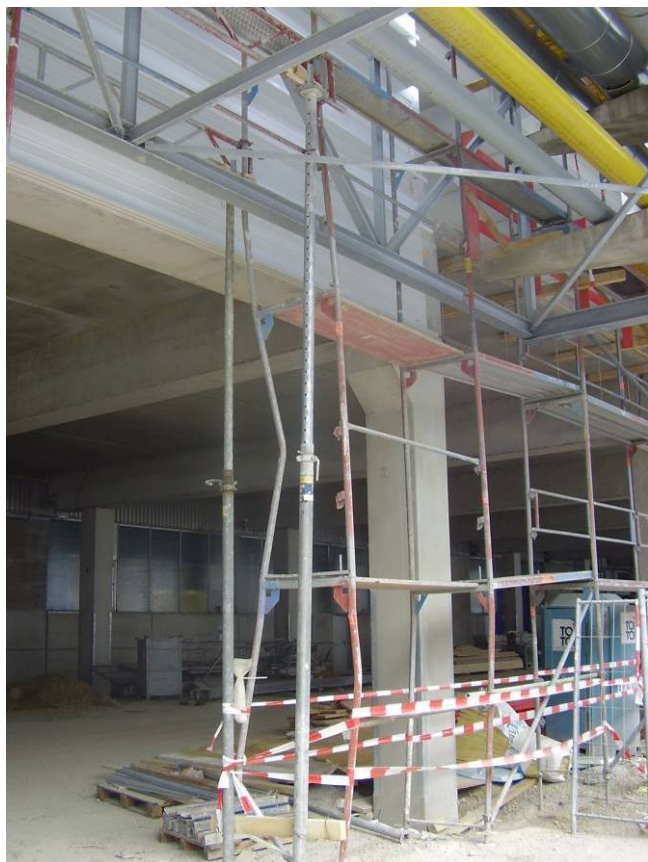
Bild 2: Beim LKW-Rangieren beschädigtes Gerüst mit nachträglich eingebauten Baustahlstützen
