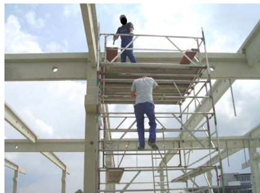
Bild 7: Fahrbares Gerüst: unzulässiger Abstieg an der Außenseite
