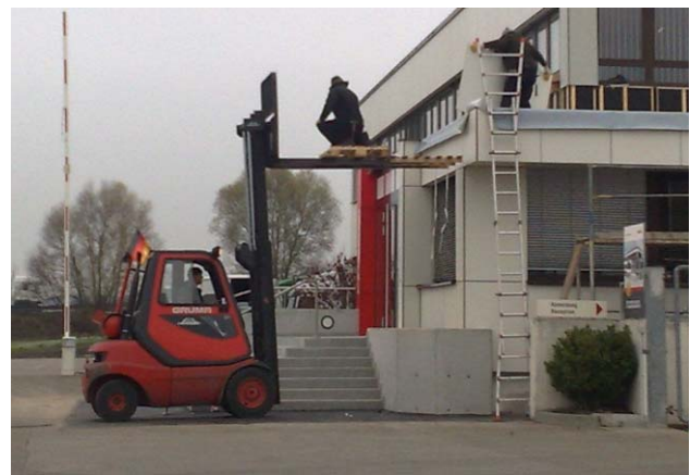
Bild 1: Europalette und Gabelstapler als Ersatz für das fehlende Arbeitsgerüst
