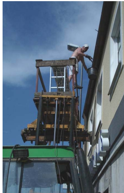
Bild 4: Selbstgebaute Arbeitsbühne mit erheblichen Mängeln
