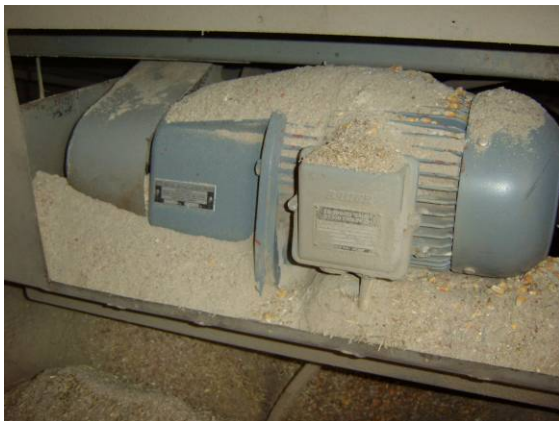
Abb. 1: Elektromotor in einem Separator
