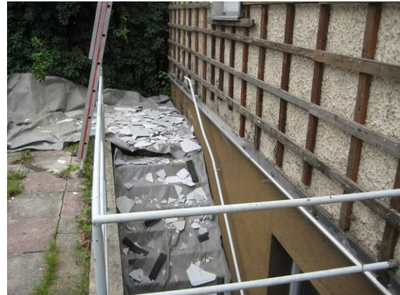
Abb. 3: Unsachgemäße Demontage von Asbestzementplatten
