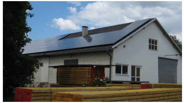
Bild 8: In Bayern nicht mehr: Neuinstallation von Photovoltaikanlagen auf Asbestzementdächern
