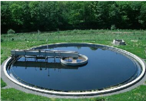
Abb. 3 Nachklärbecken ohne Absturzsicherung
