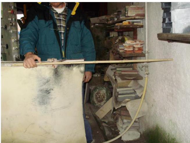
Mögliche Quetschstelle zwischen Spritzschutz und Wand
