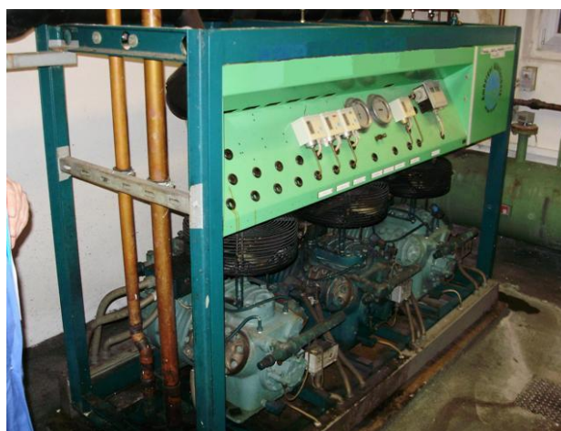
Abb. 6 Kälteanlage in einem fleischverarbeitenden Betrieb
