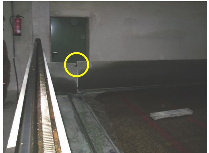
Blick auf das untere Ende des Arbeitstisches: Spritzwasserschutz mit Tür ohne Endschalter
