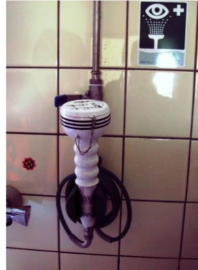
Abb. 4 fest installierte Augendusche
