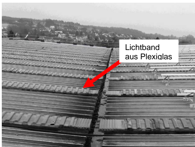
Abb. 1: Dachoberseite mit ungesicherten, nicht durchtrittssicheren Lichtbändern
