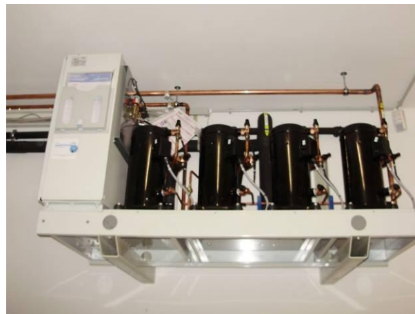
Abb. 3 Kälteanlage in einem Verbrauchermarkt
