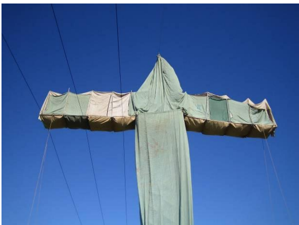
Abb. 1: Komplett eingehauster Freileitungsmast
