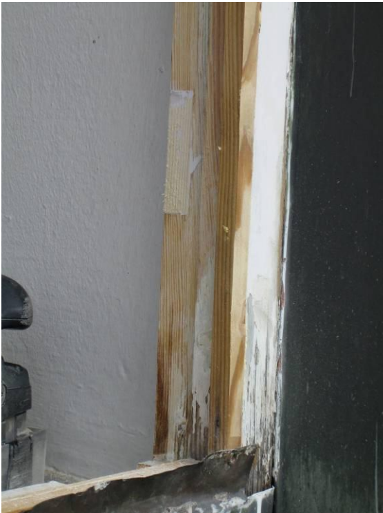
Abb. 2: Fensterstock während des Versuchs einer thermische Entfernung bleihaltiger Anstriche
